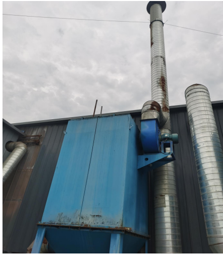
图 4 袋式除尘器+DA001 排气筒
