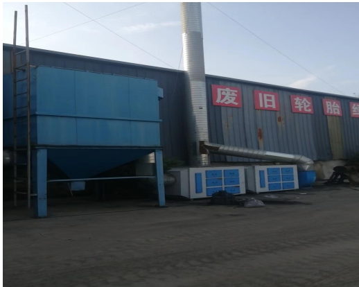
图 7 袋式除尘器+两级活性炭箱+DA002排气筒
