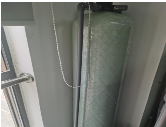
图 2 一体化污水处理设备吸附罐
