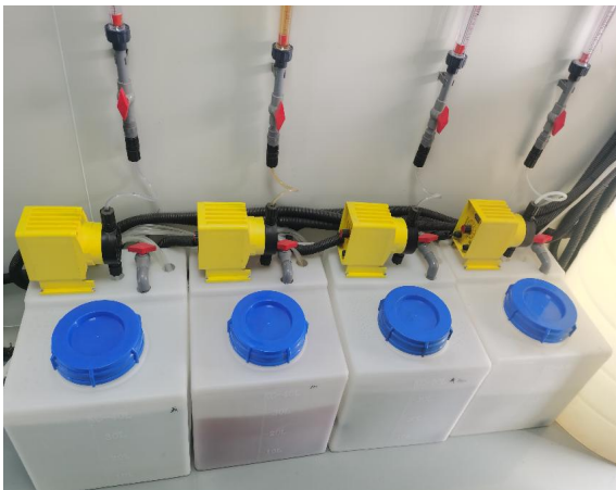
图 1 一体化污水处理设备加药罐（TW001）
