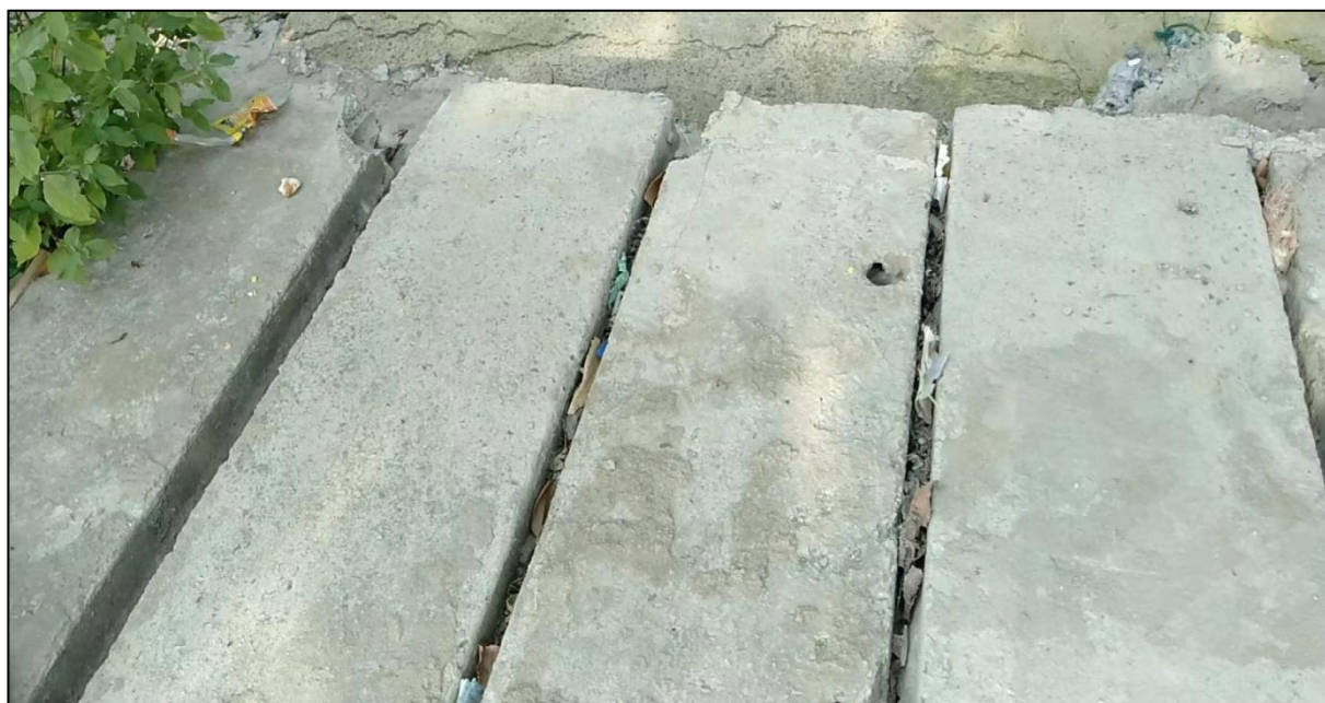
图 4-1 化粪池图（依托颍上县汇博装饰涂料有限公司）
