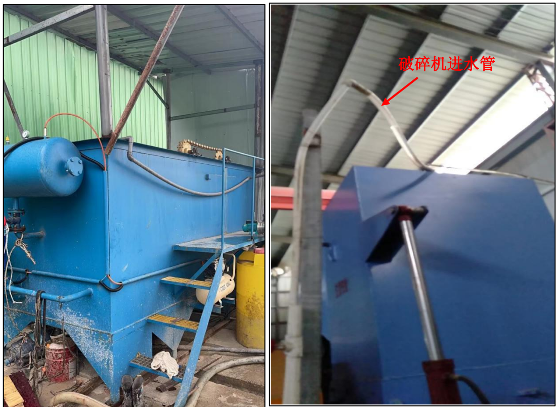
图 4-3 污水处理站及破碎机全密闭情况图
