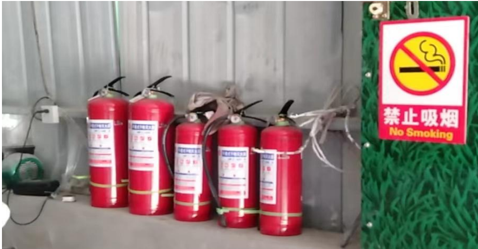
图 4-9 厂区车间灭火器
