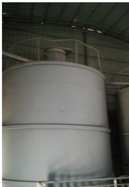
图 14 粉煤灰筒仓仓顶除尘器 TA007
