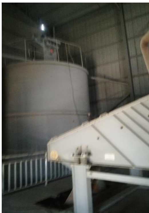
图 13 水泥筒仓仓顶除尘器 TA006
