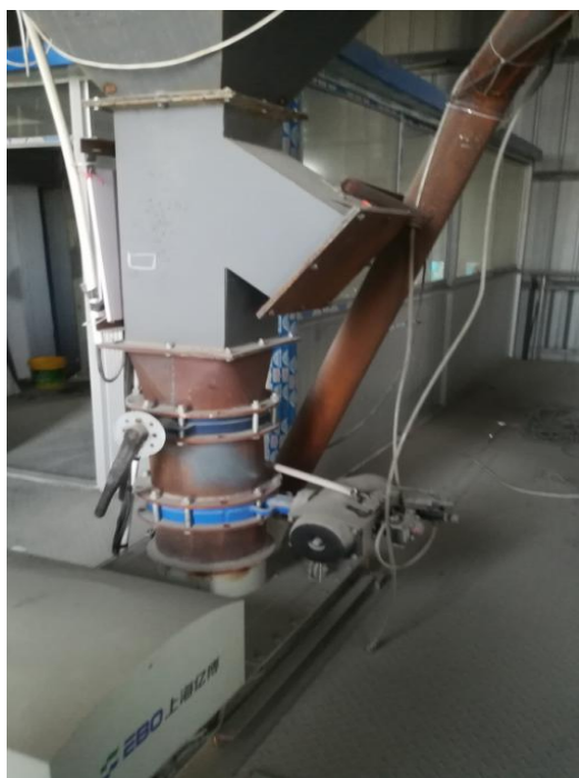
图 25 原料传输管道密闭
