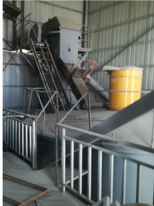
图 8 300t 混合仓仓顶除尘器 TA003
