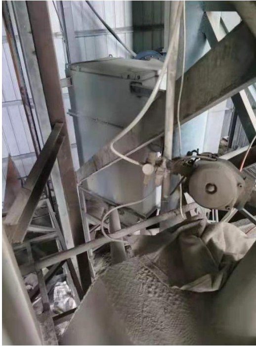
图 7 提升机除尘器 TA002
