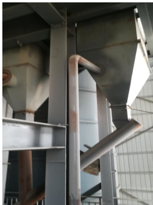
图 22 集尘管道至袋式除尘器全封闭
