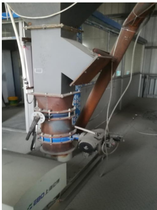
图 21 原料传输管道密闭
