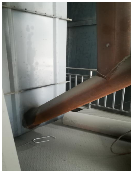
图 23 提升机与集尘管道连接密闭
