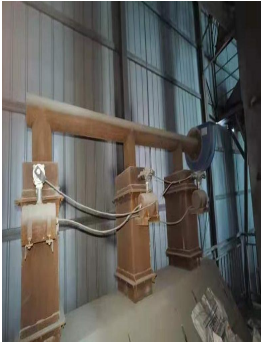
图 15 3 个添加剂仓粉尘除尘器 (TA008、TA009、TA010)
