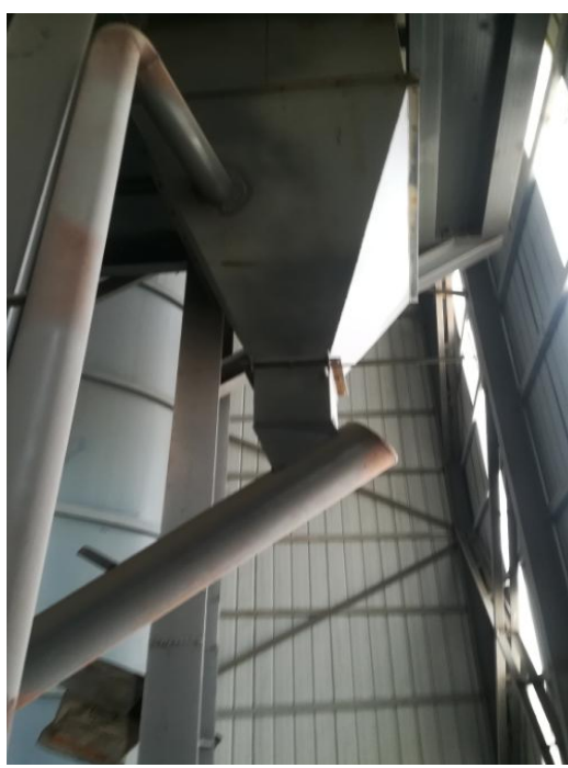
图 26 集尘管道至袋式除尘器全封闭
